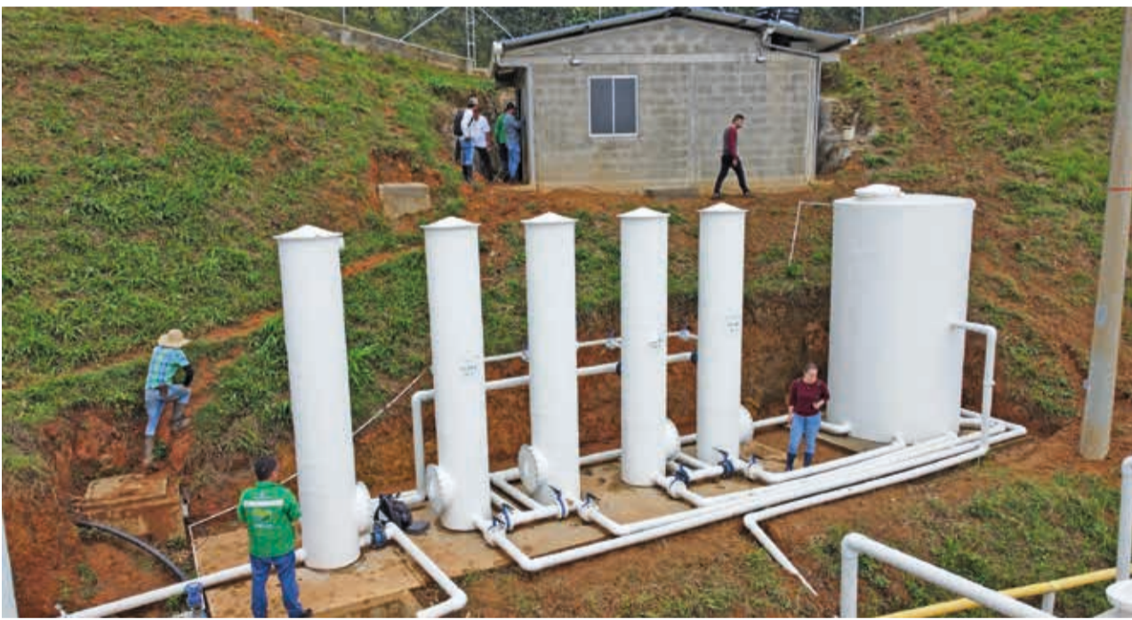
Planta de Tratamiento de Agua Potable en el municipio de Concordia.
