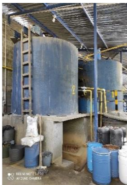
Foto 6: Tanques de cianuración
